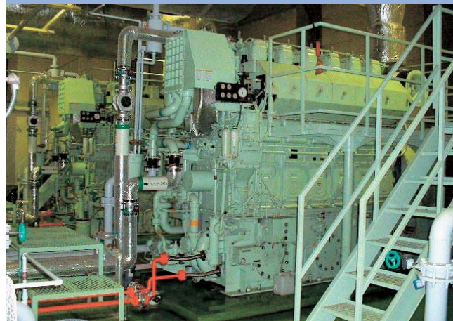
■ 曙ブレーキ山形製造株式会社コジェネレーションシステムの外観
