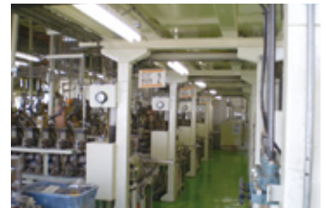
福島製造(株)の照明設備
