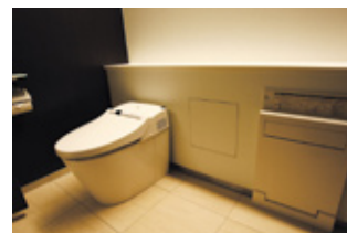
雨水を利用し年間約1,300tを節水できるトイレ
