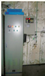
インバーターコントロール制御盤
