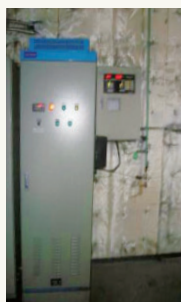
インバーターコントロール制御盤
