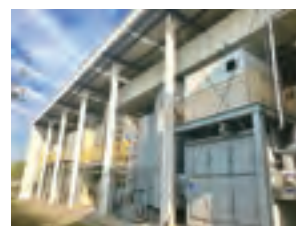
蘇州の大気浄化システム 一部
